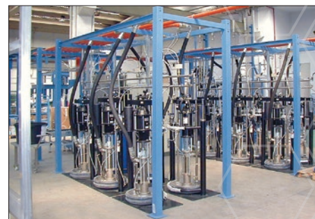
Bombas de pistão de extrusão grande, proporção de 13:1, instaladas em um processo de sistema de formulação de tinta offset
