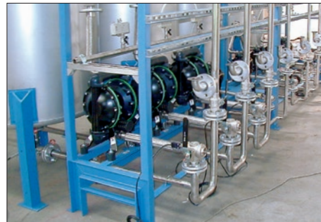
Bombas de diafragma de alumínio de 1 1/2" instaladas para alimentar um reator químico
