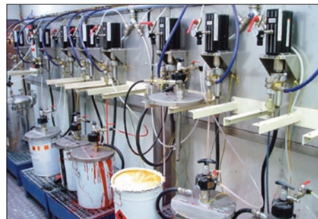
Bombas de pistão de 2 esferas proporção de 4:1, usada em um processo de fabricação de tintas
